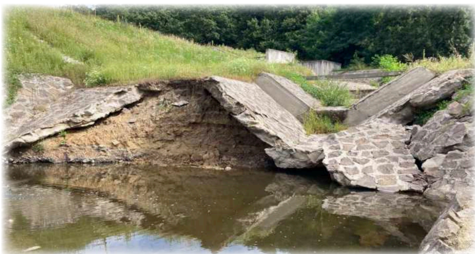
4. kép: A megrongálódott Ecsegi-tározó
